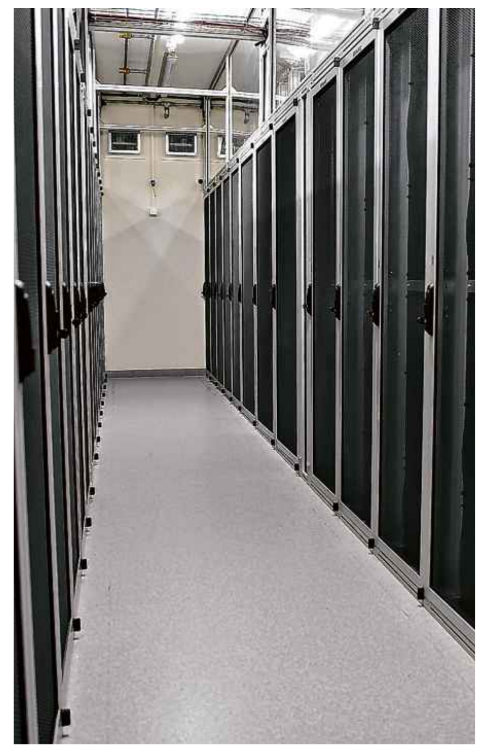
Ein Blick ins Innere des S-IT-Rechenzentrums.
