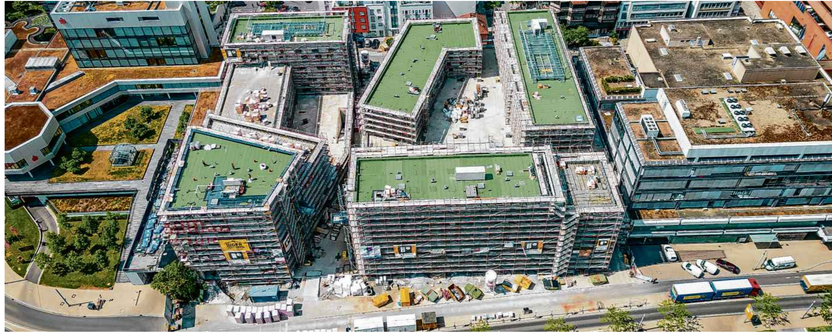
Das Wohn- und Geschäftshaus „Pulse“ an der Tübinger Allee in Böblingen geht seiner Vollendung entgegen.
